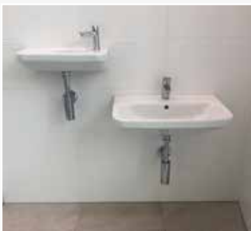
Handwaschbecken WC & Waschbecken Bad
